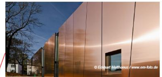
Revêtement de façade en cuivre à proscrire si la façade est ensoleillée (danger de brûlure). (photo : © Eckhart Matthaeus / www.em-foto.de)
